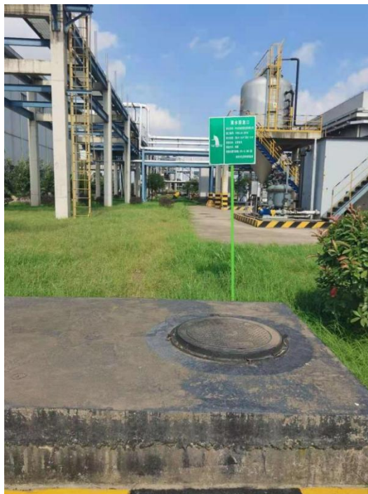
雨水排口照片
